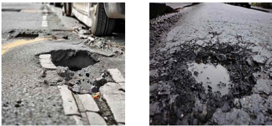
그림 7. 플레이그라운드에서 생성된 포트홀 이미지 Fig. 7. Pothole image created by Playground
