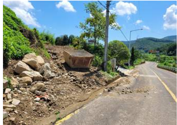
그림 14. Town(22) 도로 낙석 Fig. 14. Town(22) road rock fall
