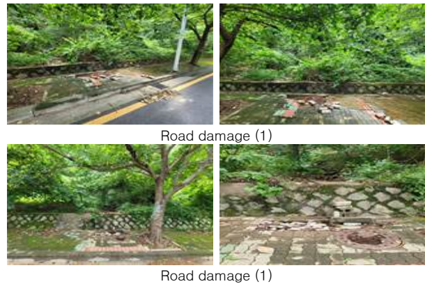
그림 11. Town(20) 보행로 파손 Fig. 11. Town(20) pedestrian road damage
